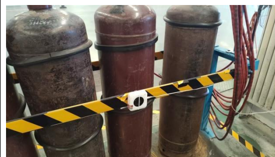
丙烷泄漏报警器
