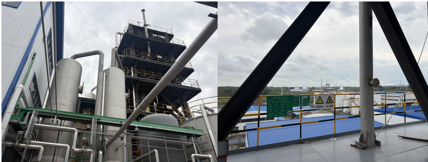
合成废气、滤液接收罐废气处置及排放
